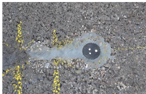
Road sensor: temperature, contenuto di sale, stato superficie suolo
